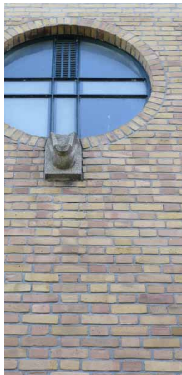
poreus geworden metselwerk door te stevig reinigen
