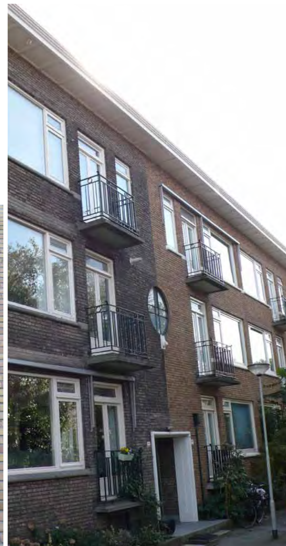
Afwijking van kleur metselwerk door partieel reinigen doet afbreuk aan uniformiteit.
