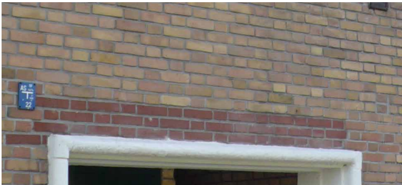
In kleur niet aansluitend metselwerk, rood ipv geelgemeleerd.
